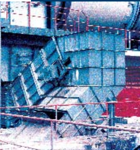
Naßentascher (200 t/T) einer Industriemüllverbrennungsanlage (Österreich)
